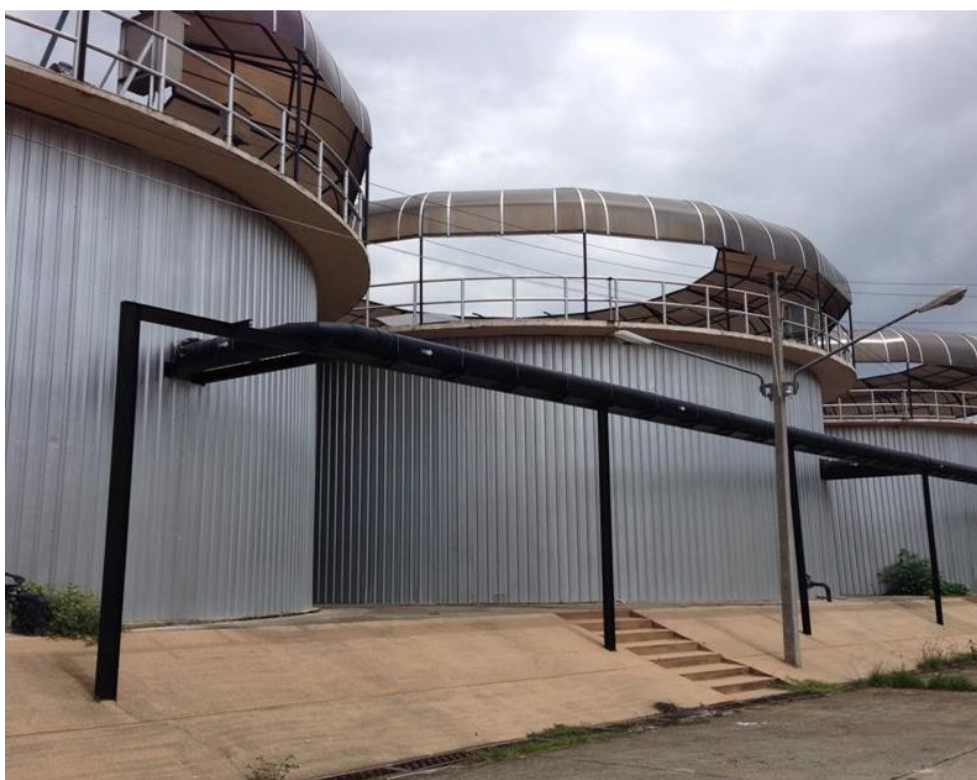
บ่อบำบัดน้ำเสีย
